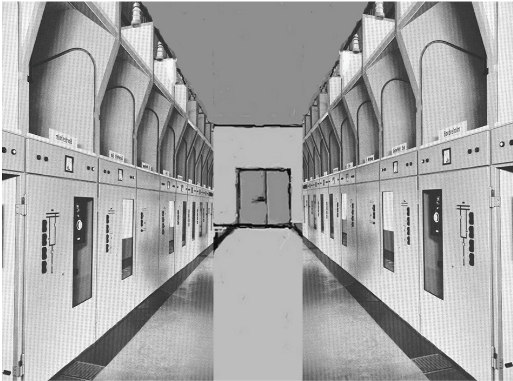
Abb. 16: Etwa so wie in dieser Montage muss man sich den Mittelgang des Schalthauses vorstellen – es gab zwei Reihen mit je 8 Schaltern 35
