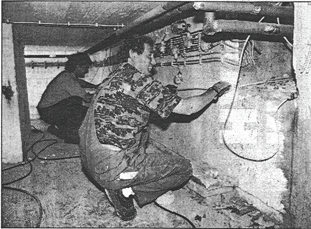
Elektriker Bernd Fleiß nimmt die Stromkabel entgegen, die an der Fußbodendecke entlang durch den Saal geführt werden sollen. Foto Lebs
