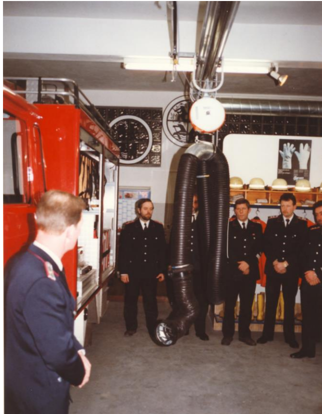
Vorstellung der neuen Abgasabsauganlage
