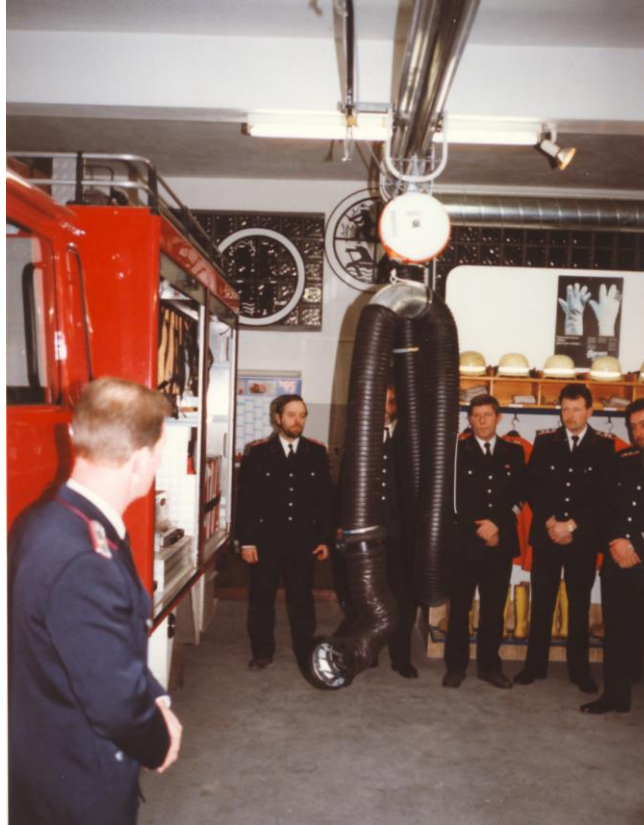
Vorstellung der neuen Abgasabsauganlage
